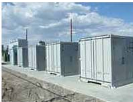
0.8MW 鉛蓄電池システム
