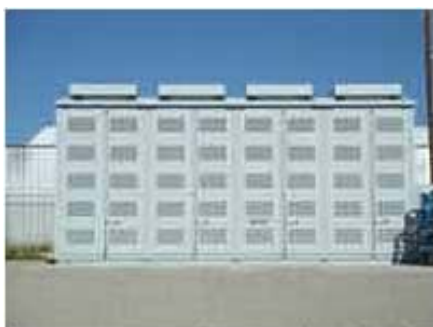
1.0MWNAS 電池システム
